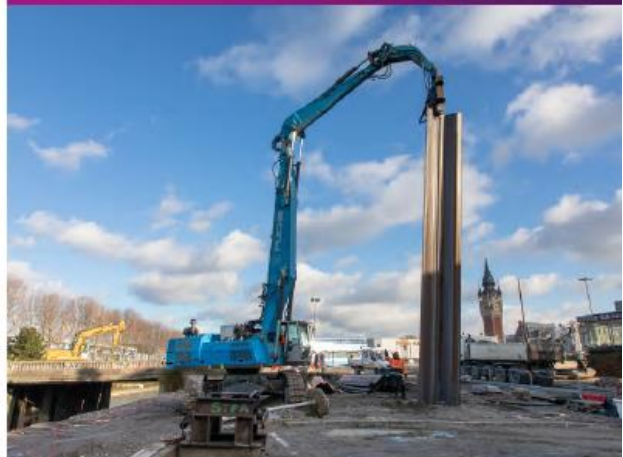
Implantation de palplanches pour renforcer le talus qui accueillera l'escalier gradin Décembre 2020
